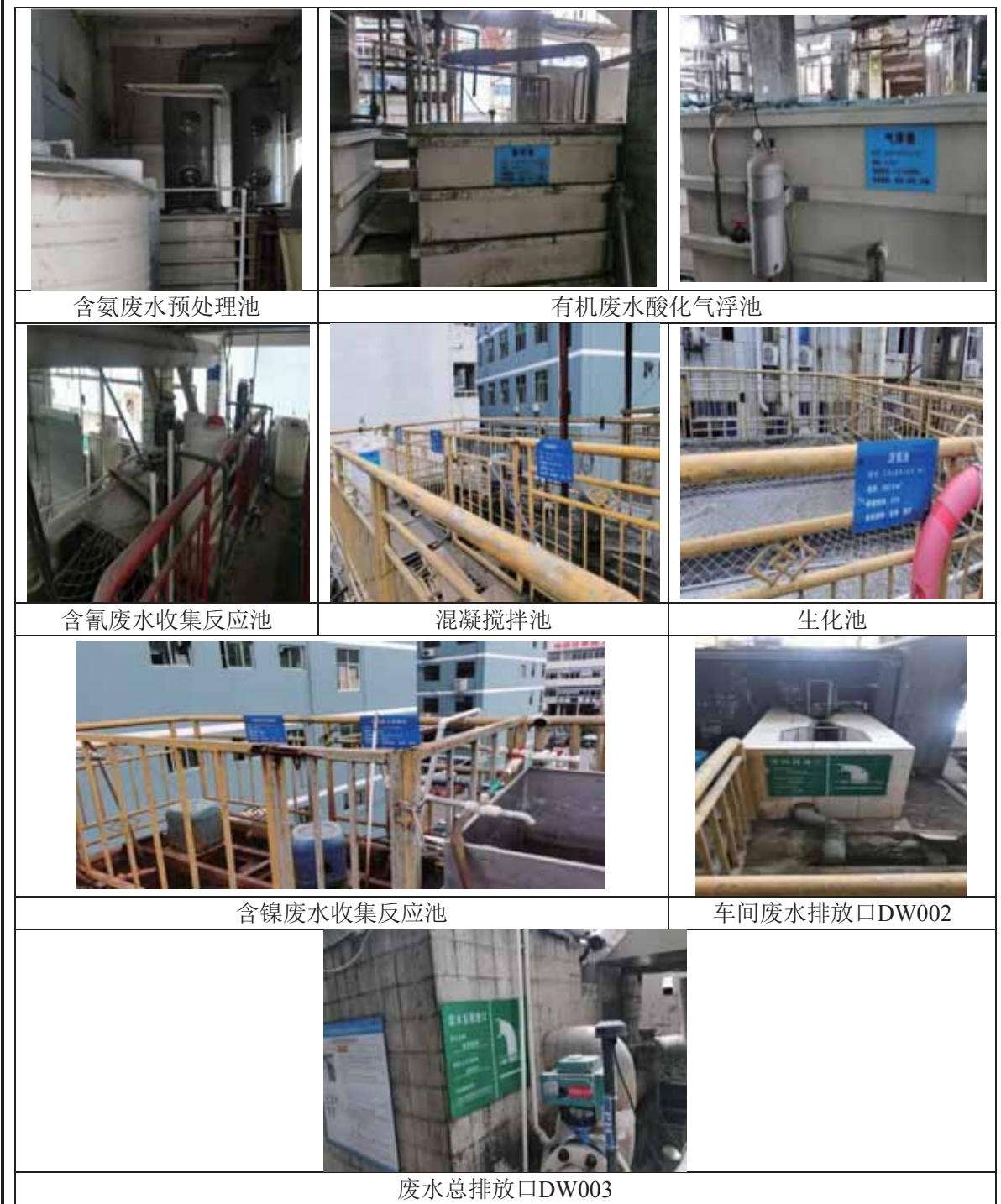
图2-6 全厂改造后废水处理设施现场照片
